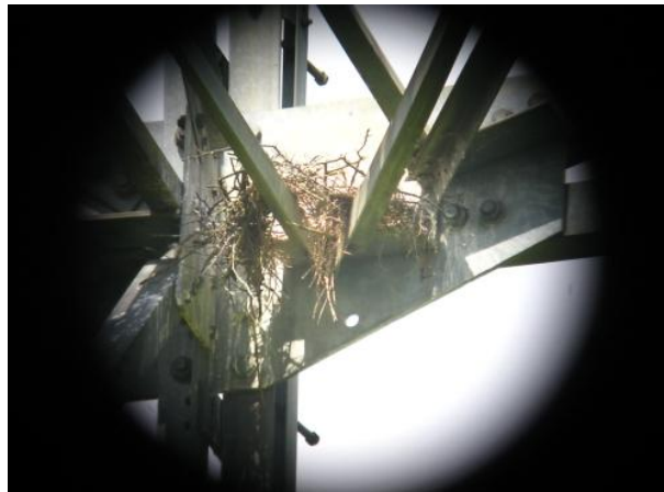
17 mai 2009. Après le constat d'échec
