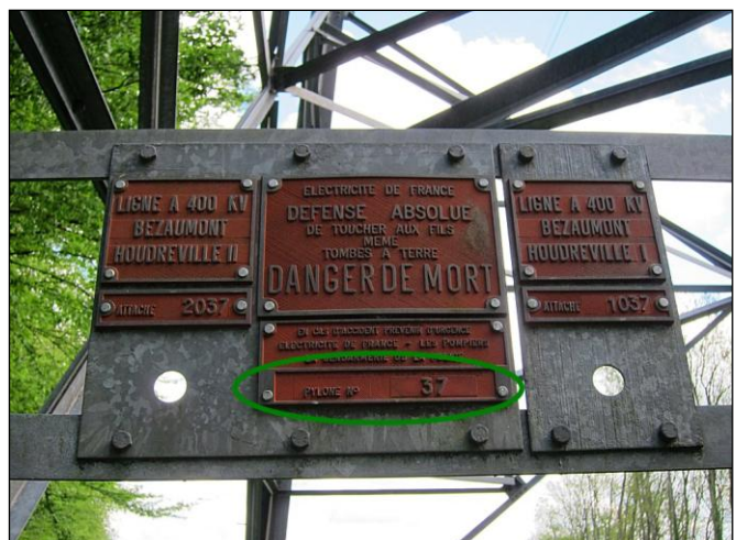
Numéro de pylône dans le cercle vert.
